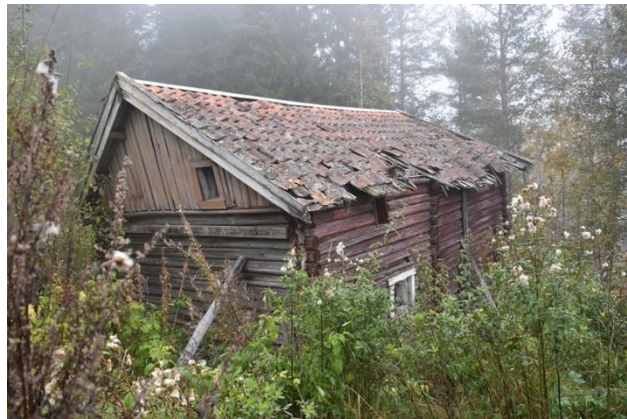
Bygningen står til nedfalls, og tilstanden er kritisk.
